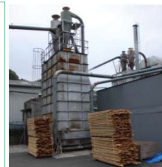
▲木質バイオマスボイラー
