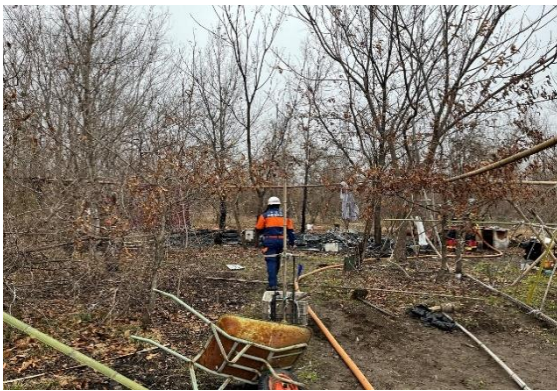
【写真-6 消火後の写真】
