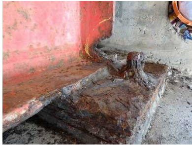
写真-3 支承部の損傷写真
