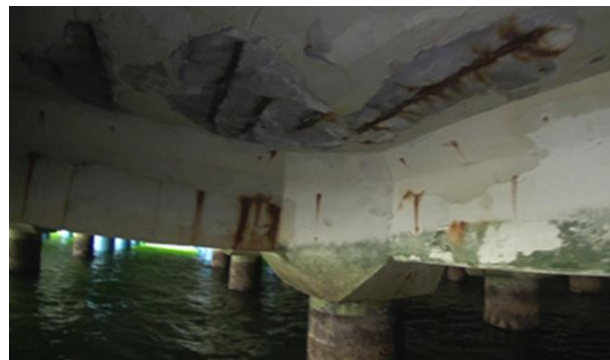
図-8 コンクリート剥離状況（塩害）
