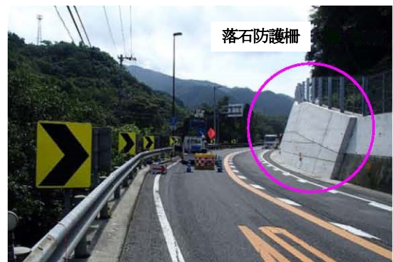
写真-1 高知側の状況
