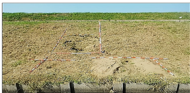
図-15 パイピングが原因の陥没及び噴砂
