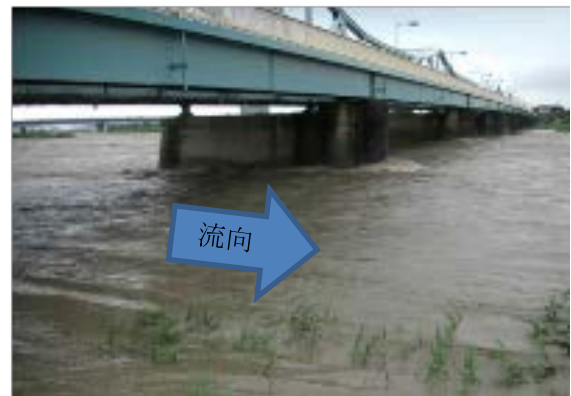
図-2 平成 29 年 9 月豪雨 重信橋付近（出水状況）
