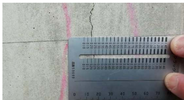
写真-1 過年度工事で生じたひび割れ (0.25mm)
