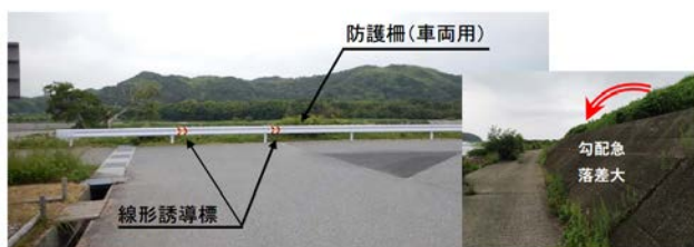
◎落下対策（落差が大きく勾配も急な箇所）
