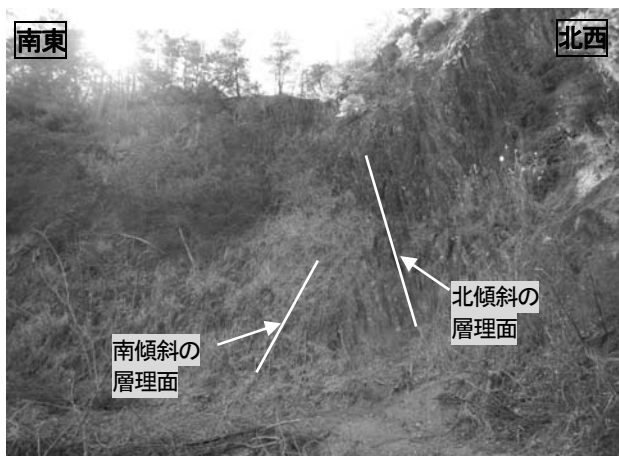
写真-1 調査地より南東側の切土面
