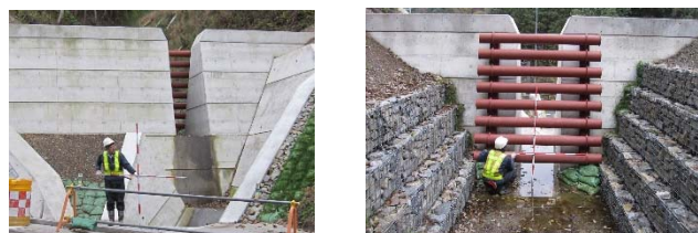
写真-4 透過型砂防堰堤工
