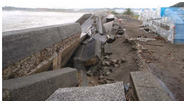
図-3 平成26年度災害人工リーフ背後堤防崩壊
