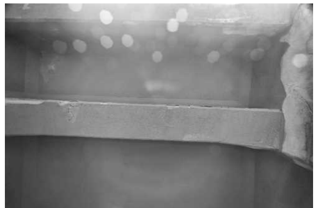
図-5 第1スパン南側の欠損部の写真
