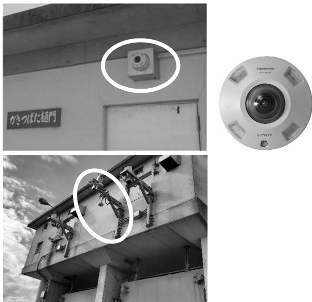
図3 かきつばた樋門 使用カメラ及び設置状況 (上：堤内側、下：堤外側)
