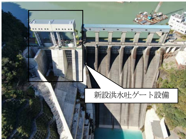
図ー1 長安ロダム洪水吐ゲート設備
