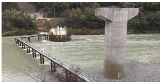
写真-5 施工ヤード冠水状況 (R2.1.28撮影)
