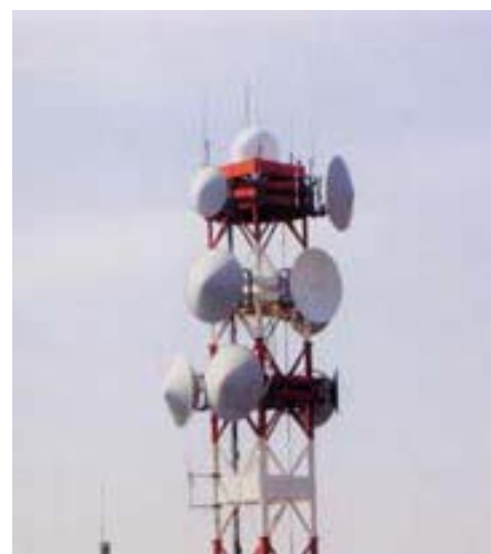
図-2 多重無線施設
