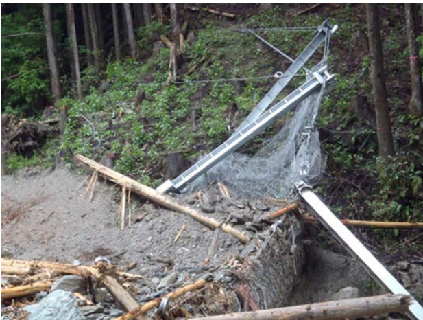
図-12 ワイヤーネット破損
