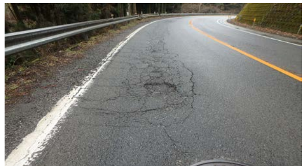
写真-2 ポットホール
