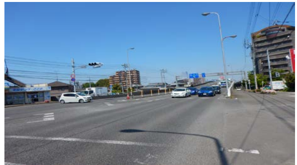
写真-1 排水性舗装の損傷箇所
