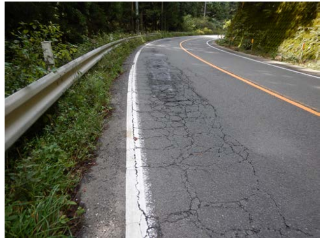
写真-4 国道33号 久万高原町下野尻
