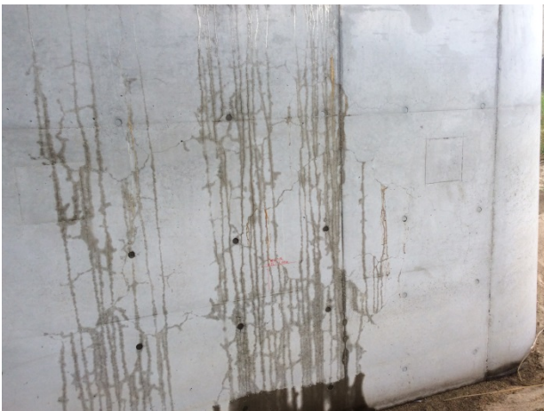
図ー1 ひび割れからサビがにじむ橋脚補強コンクリート
