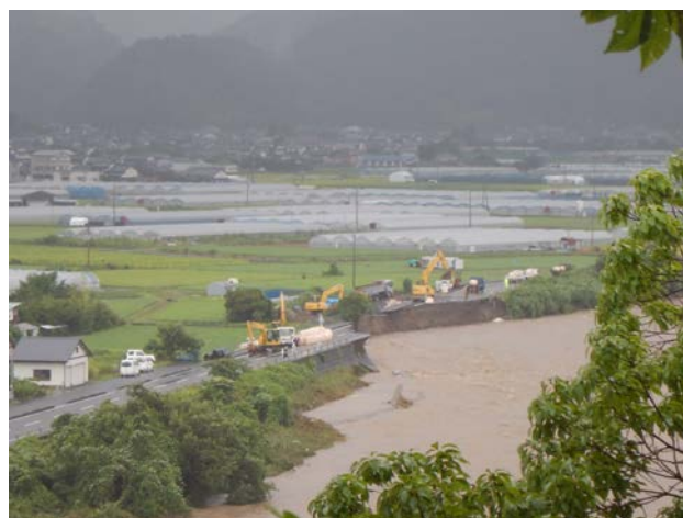
写真-4 安芸川堤防浸食状況
