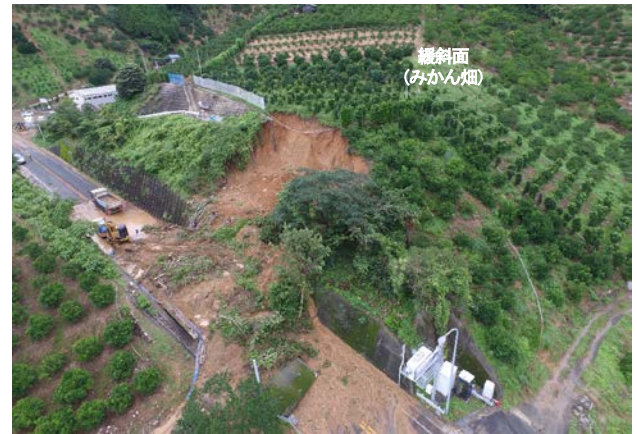
写真-3 白浦地区 (215k890) 地すべりの全景
