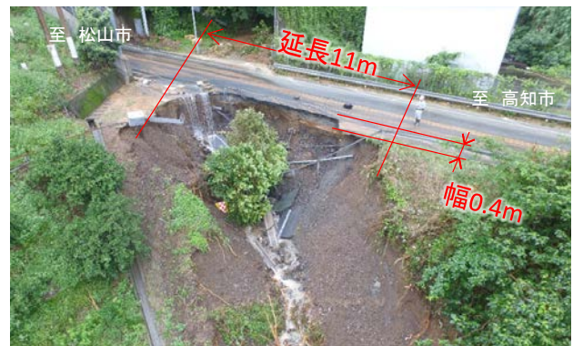
写真-4 白浦地区 (216k200) 盛土流出の全景
