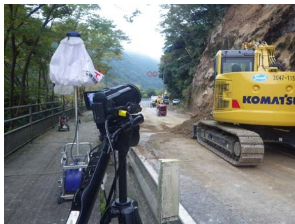
写真-6 CCTVカメラの配置状況
