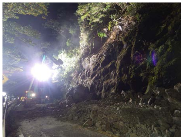
写真-7 照明車の配置状況
