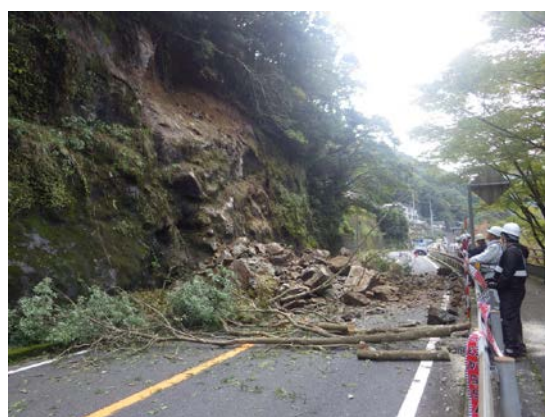
写真-1 被災状況
