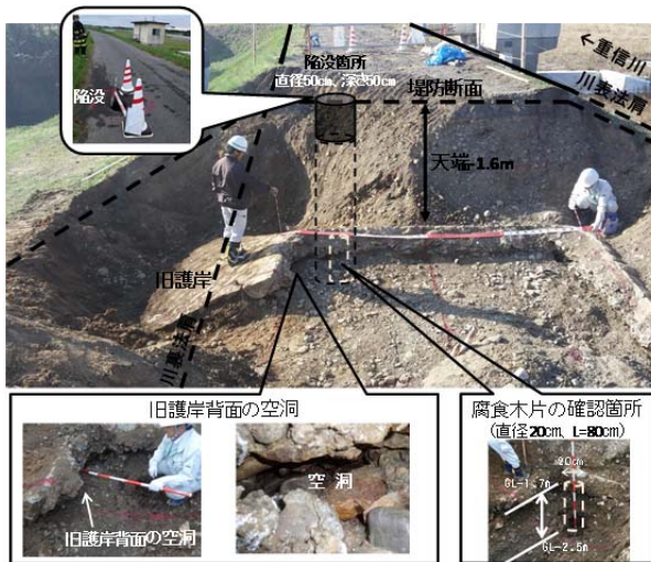
図-1 陥没発生箇所の要因調査(H27：船川堤防の陥没)
