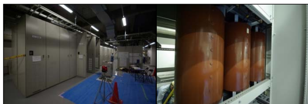
図-4 特高電気室写真（左側：全景 右側：変圧器）
