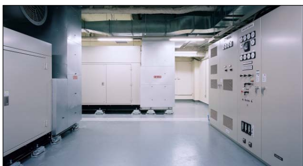
図-2 自家発電設備（北館発電機室） 正面が庁舎用、左側が官署専用
