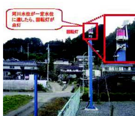
回転灯の設置
