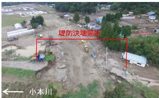
堤防決壊状況
