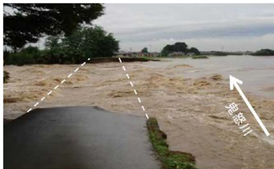
決壊箇所の状況（9 月 10 日）
