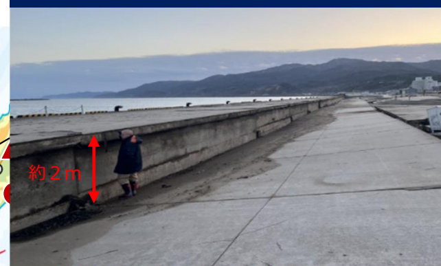
岸壁背後の用地の沈下
