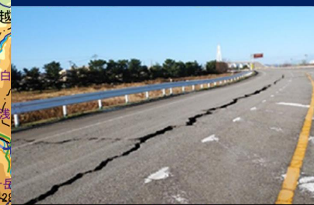
臨港道路の亀裂
