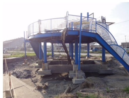
津波避難タワーの基礎部分が洗掘 （東日本大震災：石巻市）
