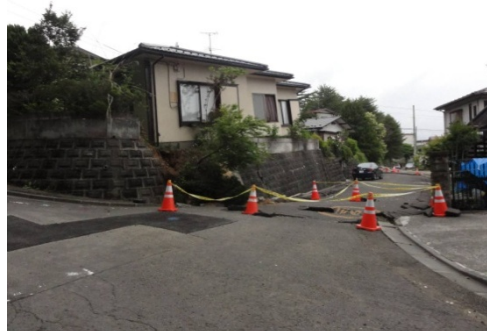
盛土造成地における被害状況 (東日本大震災：仙台市青葉区)
