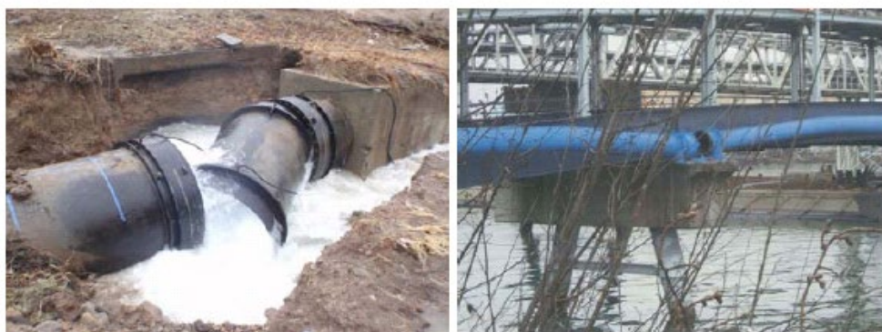
ライフラインの破損状況
