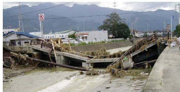
滝の宮歩道橋の崩壊
