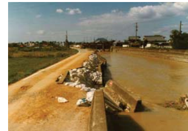
昭和58年台風10号による被災状況
