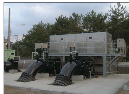
増設された梅川雨水排水ポンプ場
