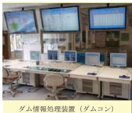
ダム情報処理装置 (ダムコン)
