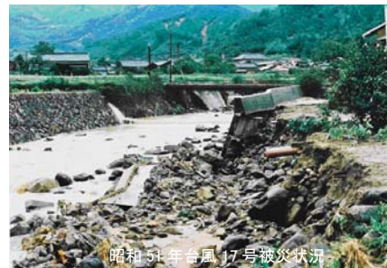
昭和 51 年台風 17 号被災状況
