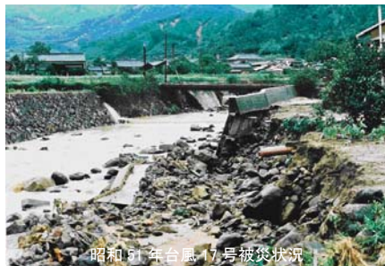
昭和51年台風17号被災状況
