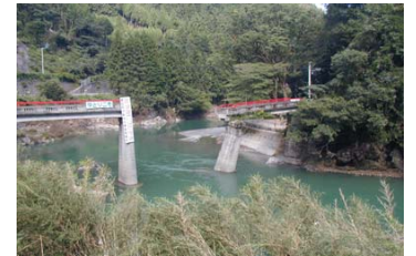
平成16年8月台風16号による被災状況
