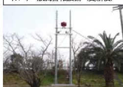
テレメータ・放流警報設備 (更新後)
