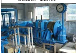
放流設備 (更新後)
