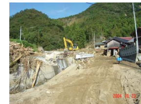
(大川地区 土石流)
