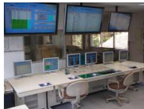
情報操作処理装置(ダムコン)
