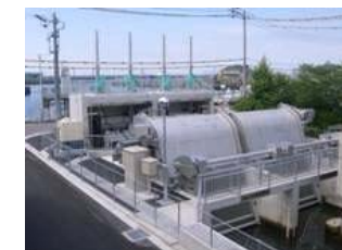
宮川ポンプ場
