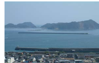
平成4年に本体工事に着工し建設が進む須崎港津波防波堤
