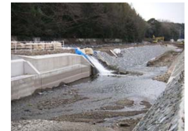
公共下水道事業の雨水排水・排出口
