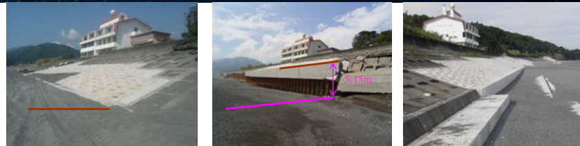
台風前地盤 台風後地盤 復旧完了
