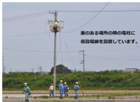
四国電力の協力による仮設電線工事の実施 出典：四国電力株式会社ウェブサイト
