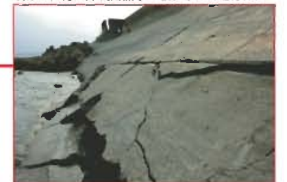
平成13年8月 台風による堤防崩壊状況
