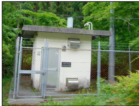
雨量観測設備 (他ダム事例)
