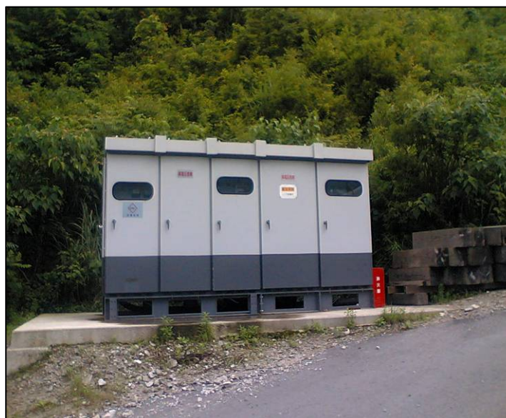
電力設備（他ダム事例）
