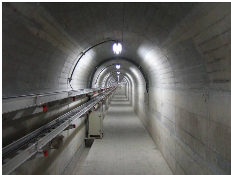
照明設備 (他ダム事例)
