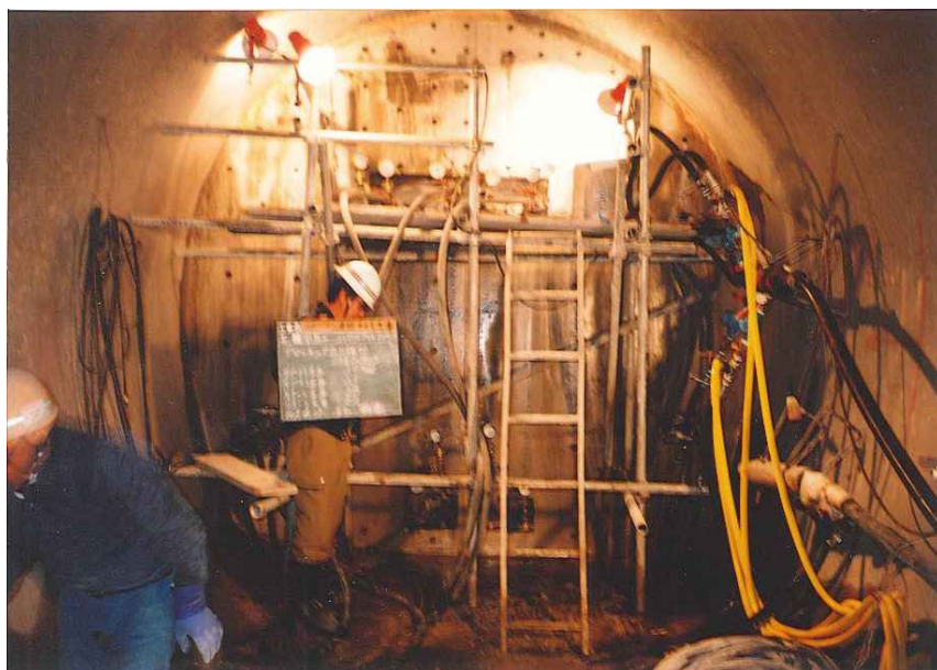
仮排水路閉塞状況 (他ダム事例)
