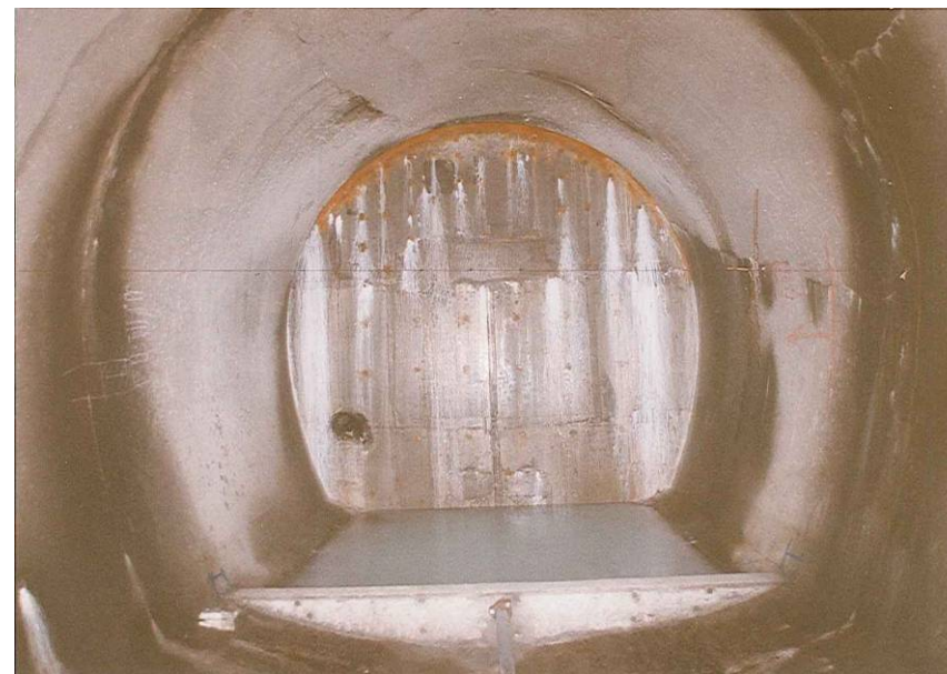
仮排水路閉塞 (他ダム事例)
