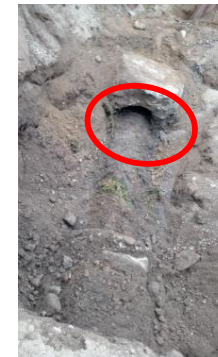
横断水路継ぎ目部に隙間が発生
