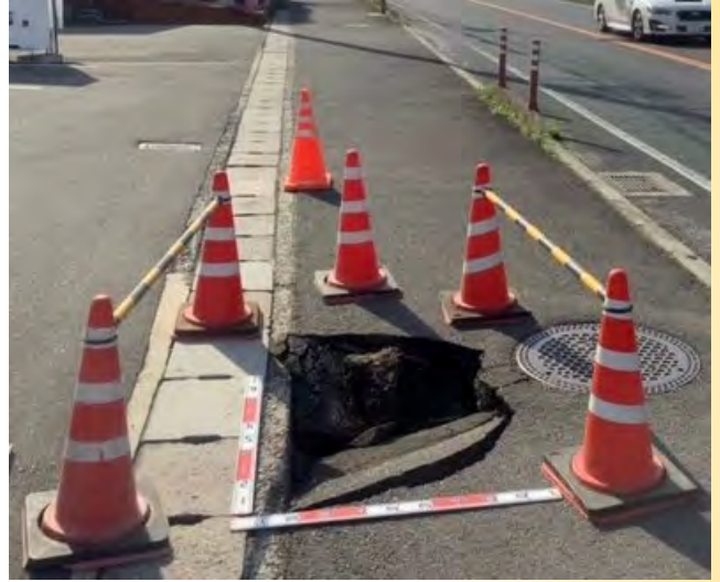
地下埋設物に起因する歩道の陥没
